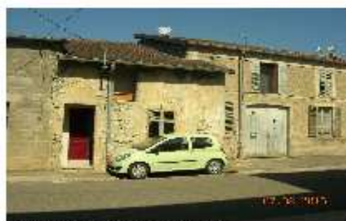
26A Grande rue (0100) réhabilitation partielle à conforter
