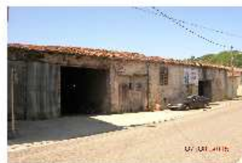
rue Michel Simon (0112) constructions insalubres & danger
