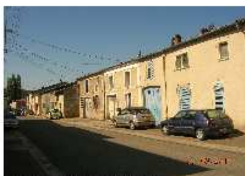
34 Grande Rue (0096) sur-épaisseur d'enduit
